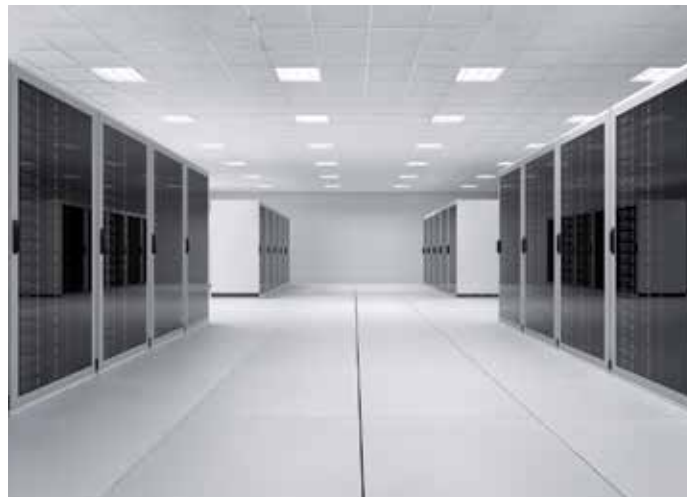
Centro de Proceso de datos - Data Centers
